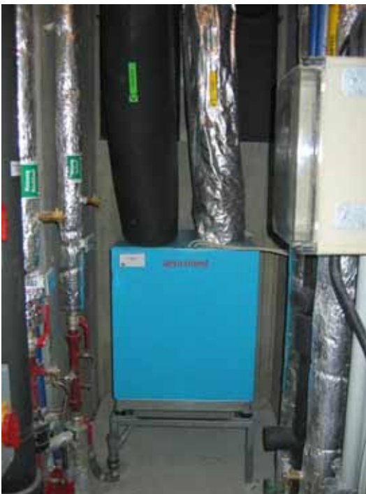
Abbildung 32: Haustechnik (Quelle: BOKU)
