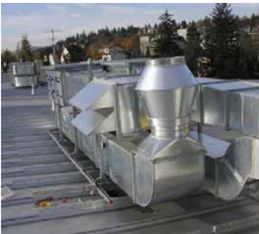
Abbildung 24: Aufdach montierte Lüftungsanlage (Quelle: AEE Intec)
